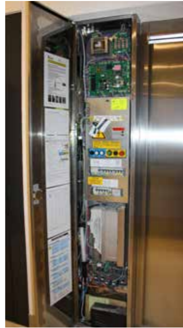
Ein Blick in die Steuerung des Personenaufzuges der Linie «Eco».
